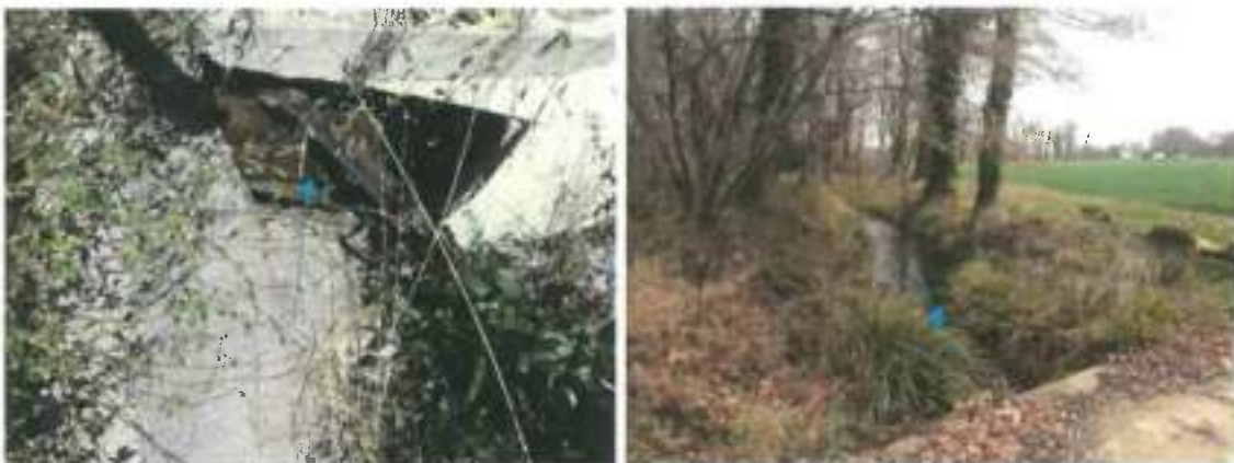
Figure 55 : Le ru de Hondaïs – embâcle sur ouvrage rocade et en amont de la confluence avec l'Arriou Merdé
