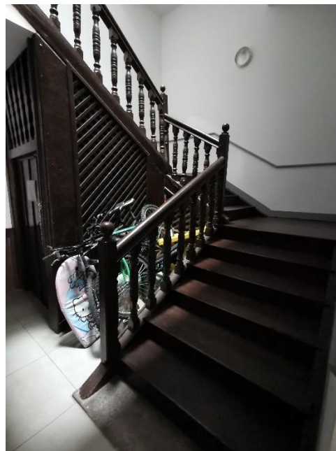
Escalier en bois, rampe sur rampe
