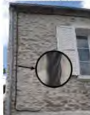
Réseau fils isolés façade BT
