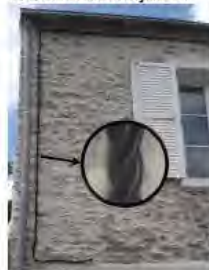
Réseau fils isolés façade BT
