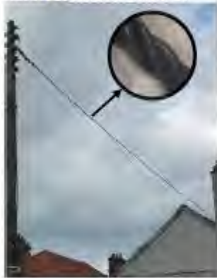
Réseau fils isolés aérien BT
