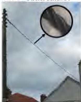
Réseau fils isolés aérien BT
