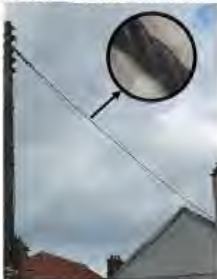
Réseau fils isolés aérien BT
