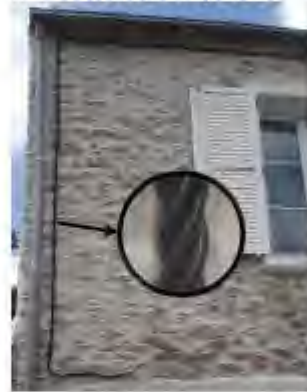
Réseau fils isolés façade BT
