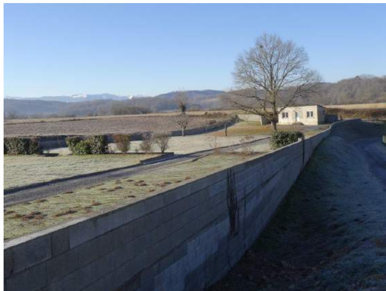
Fig. 56. Exemple de mur créant un obstacle aux écoulements
