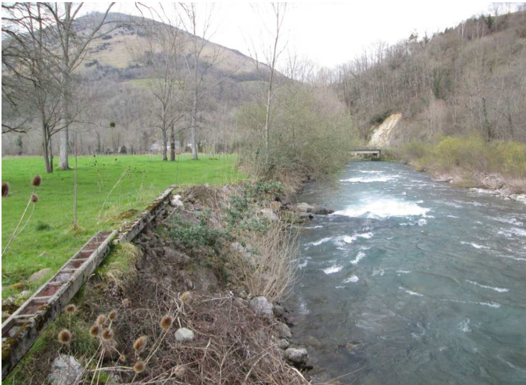
Figure 19 : Zone d'érosion en rive gauche du Saison au droit du méandre
