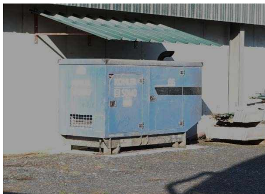
Groupe électrogène de secours ARTIFEX 2023
