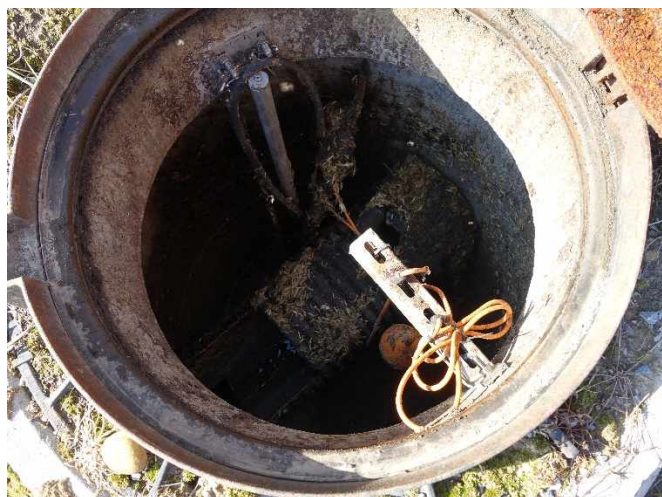
Déversoir d'orage ARTIFEX 2023
