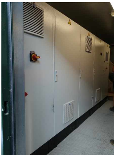
Armoires électriques ARTIFEX 2023
