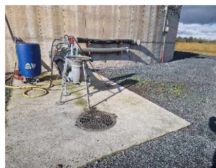
Aire de chargement du digestat brut ARTIFEX 2023
