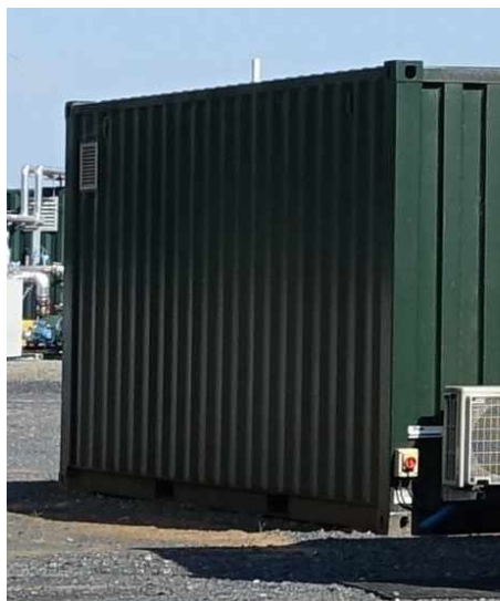
Bloc technique armoires électriques et production d'oxygène ARTIFEX 2023
