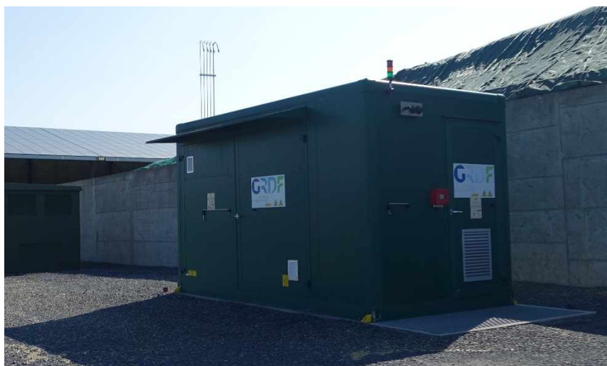
Poste d'injection GRDF ARTIFEX 2023
