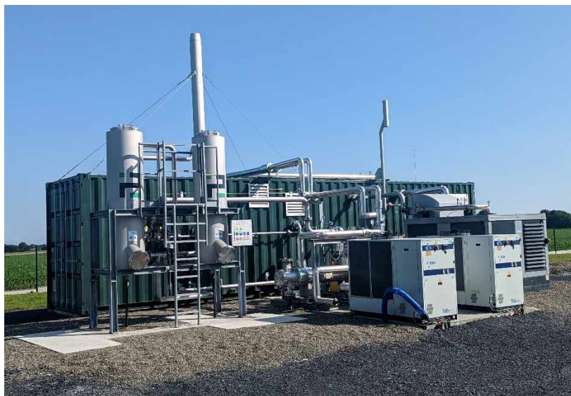
Bloc technique chaufferie et épuration PRODEVAL ARTIFEX 2023
